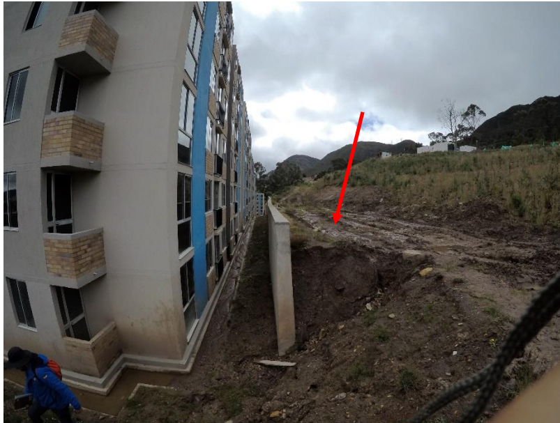
Ilustración 6 Relleno antrópico confinado con muro en concreto, parte oriental de la Urbanización Santa Teresita.
