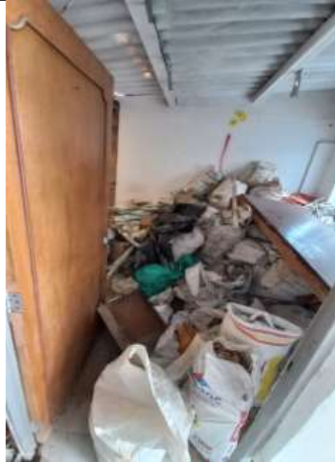
Material almacenado en cuarto de depósito de la vivienda y escombros sin retirar
