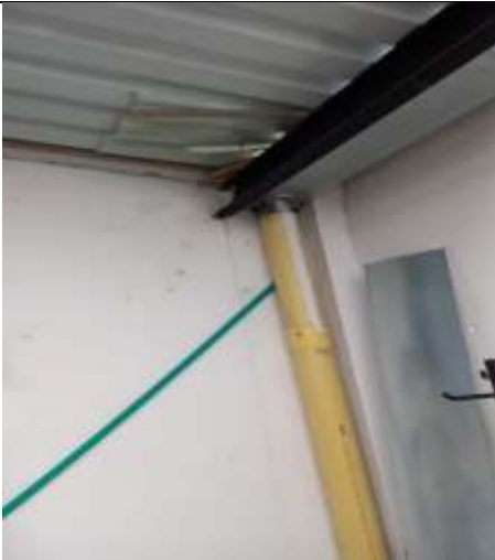
Filtración de agua por la mala instalación de las tejas y la bajante, que genera humedad
