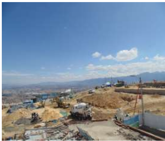
Vista del acceso principal y muros de contención para la cancha múltiple.
